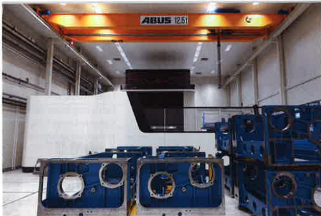
Die Raumanlage besteht aus einer Stahlkonstruktion, die als Tragwerk für die Decke und den bauseitigen 12,5 t-Kran dient.
